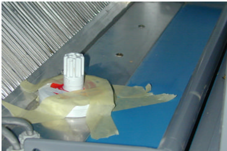
Abbildung 3.2 Ein Mess-Datenlogger für Temperatur und Feuchte direkt im Lüftungsgerät montiert
