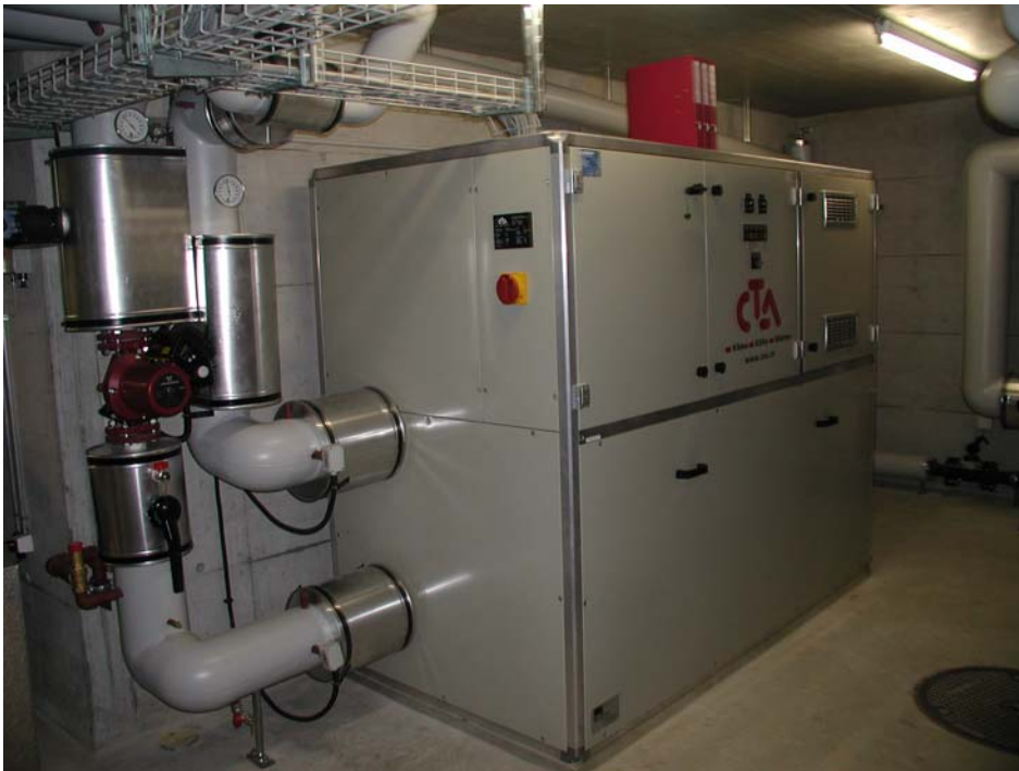
Bild 5 Ansicht der Wärmepumpe geschlossen
