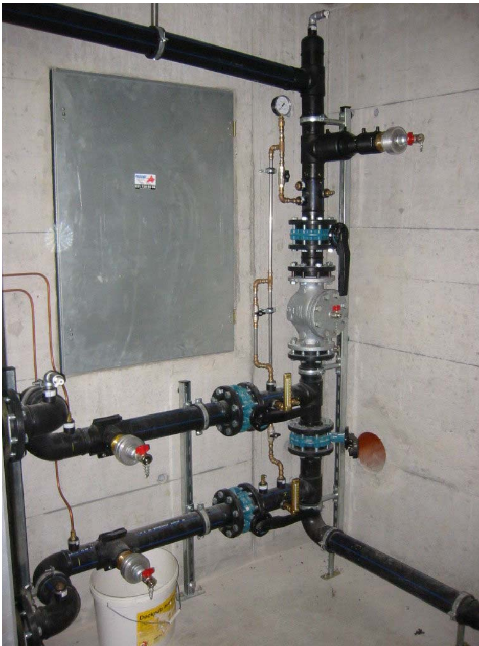
Bild 7 Ansicht Grundwassereinbindung (diverse Spülstutzen)
