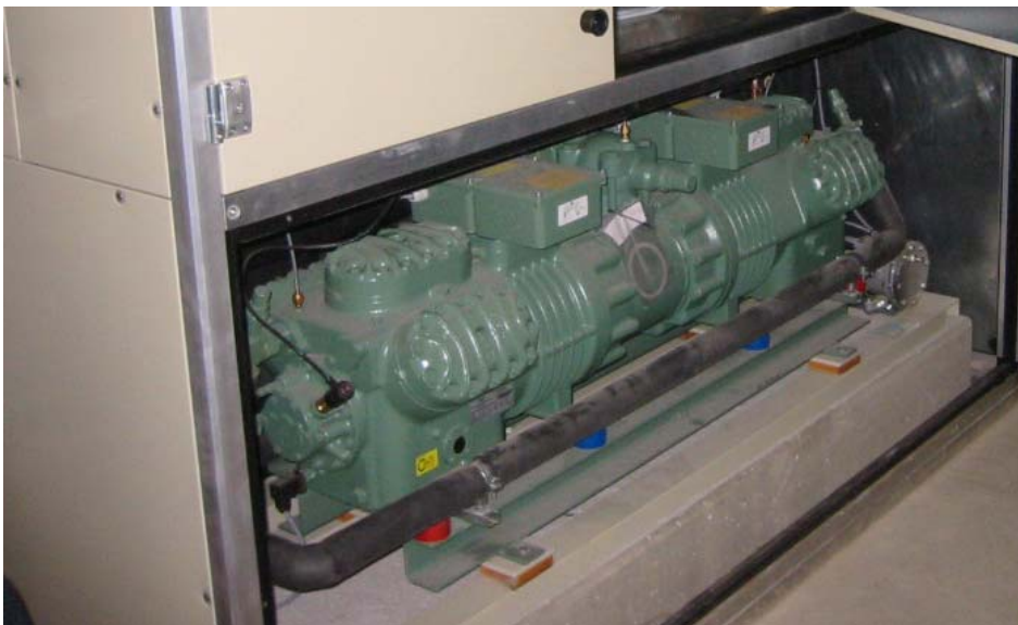
Bild 6 Ansicht der Wärmepumpe unten geöffnet (Betonsockel ersichtlich)
