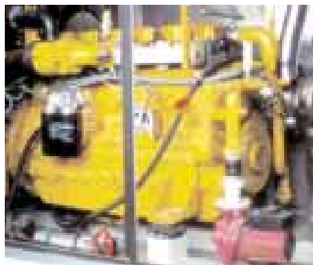
Un moteur diesel courant, mais transformé pour fonctionner au gaz, sert à la production combinée de chaleur et d'électricité.
