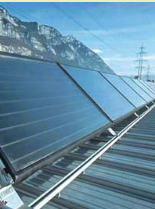
Des capteurs convertissent le rayonnement solaire en chaleur utilisable. L'installation solaire thermique sur le bâtiment de Flumroc SA à Flums et ses 192 m 2 de capteurs. (Photo: SSES)
