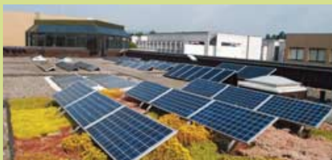
DEMOSITE: démonstration de différentes variantes d'intégration de modules photovoltaïques, par exemple, sur une toiture plate engazonnée.
