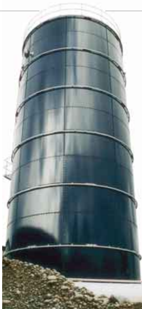
Le biogaz est produit dans ce bioréacteur de 600 m³.
