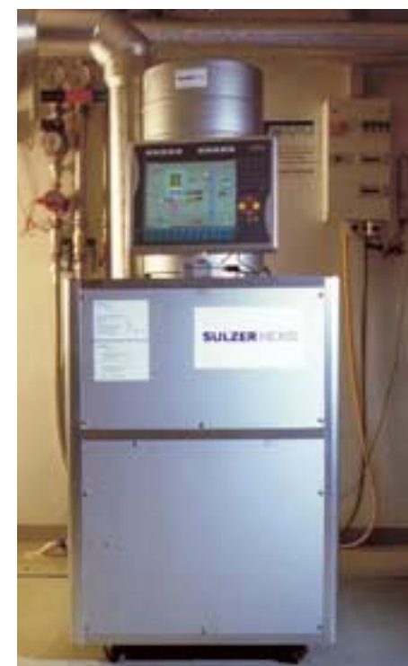
L'unité de pile à combustible Hexis a été testée pendant deux ans en conditions réelles d'exploitation. Ces essais ont porté sur six unités, avec un total de 35'000 heures de service. (Photo: Sulzer Hexis SA)
