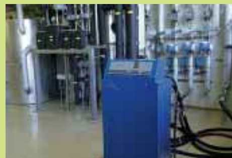
Der Prüfstand für Wasser-Wasser- und Sole-Wasser-Wärmepumpen des Prüfzentrums in Buchs wird seit Jahresbeginn genutzt.
