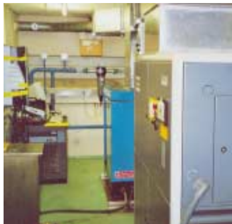
Druckluftherzeugungsanlage einer Weberei mit 30-kW-Schraubenkompressor, der vor der Untersuchung rund 6500 Jahresbetriebsstunden aufwies.
