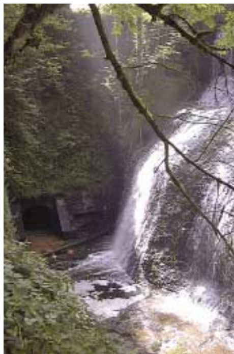
Die bestehende Staumauer Buchholz mit Grundablass und seitlicher Hochwasserentlastung ist fast vollständig von Vegetation überzogen. (Foto: Entec AG)
