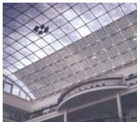
Beispiel der Integration von Solarzellen ins Gebäudedach an der Technischen Universität in München.
