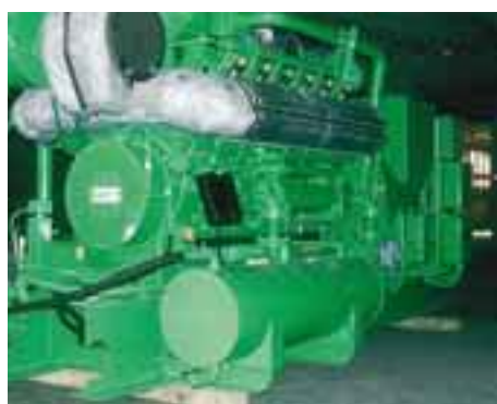
BHKW-Motor für die Strom- und Prozesswärmeerzeugung aus Biogas.
