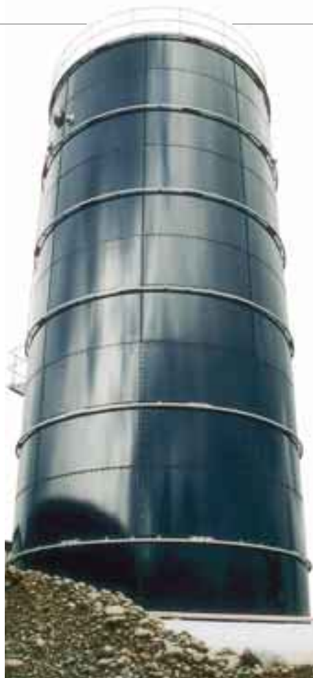
Im Bioreaktor mit 600 m³ Fassungsvermögen entsteht Biogas.
