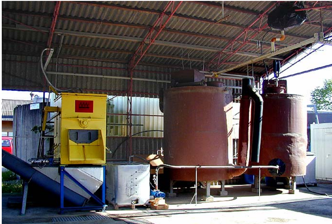
Foto 1: Die Perkulationsanlage im Pilotmasstab mit dem 1m 3 -Perkolator (links) mit dem darunter liegenden Sandabscheider und dem 4m 3 Fermenter (ganz rechts). Rechts vom Perkolator befindet sich der Pufferspeicher. Dazwischen wurde das Rotationssieb geschaltet (nicht sichtbar). Der zylindrische Fermenter in der Mitte hat nichts mit der aktuellen Anlage zu tun.
