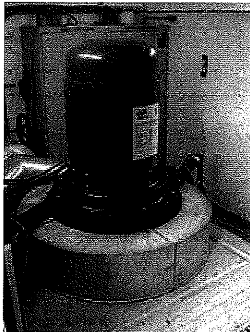
Bild 5: Photo einer ähnlichen bestehenden Anlage (ohne Bypass):
