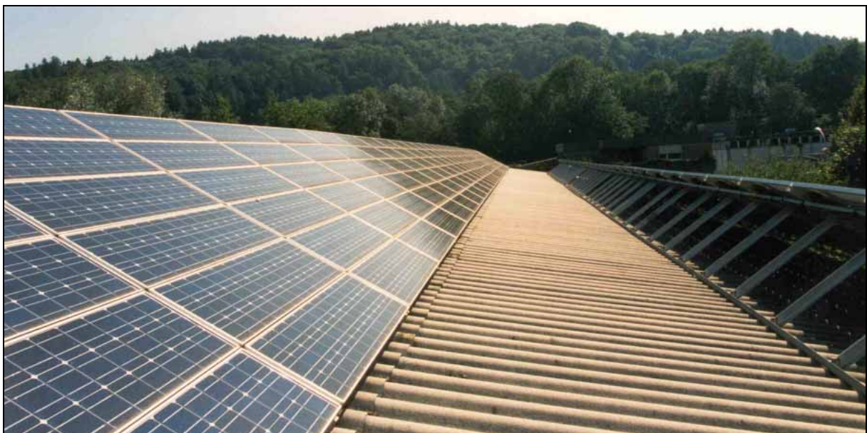
PV-Anlage Schlossmatt 1, 2, 5, 6, 7 und 8
