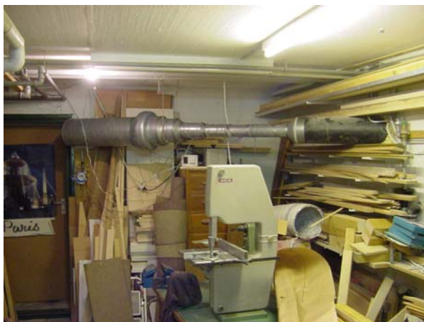
Fig. 9: Zuluftröhr mit Ventilator im Bastelraum.
