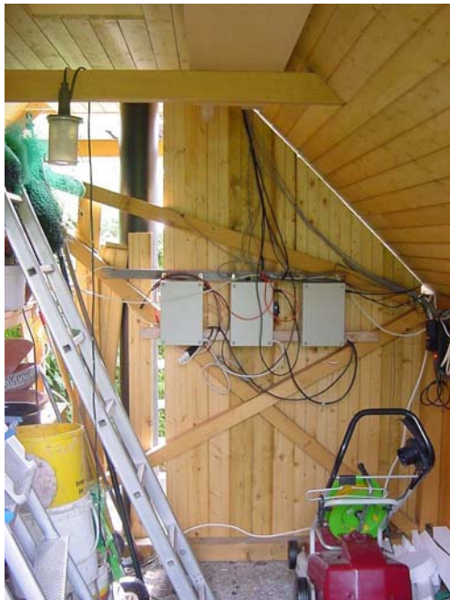
Fig. 19: Die 3 Wechselrichter und ein paar Messkabel
