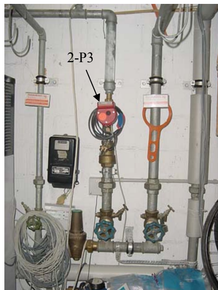
Fig. 17: Impulszähler Durchfluss Warmwasser
