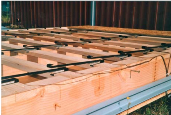
Fig. 13: Montierte Haken für die Module
