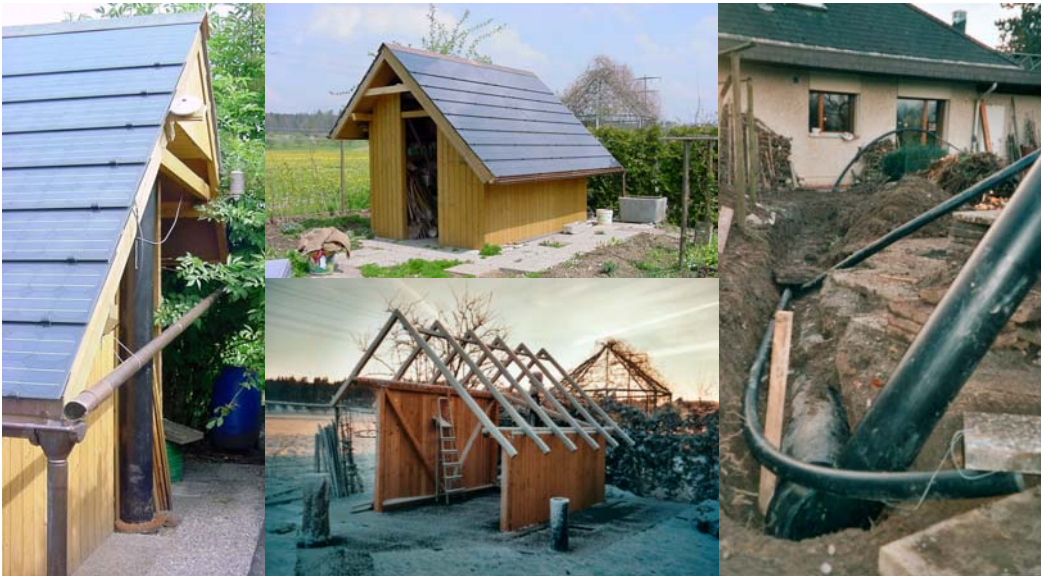
Figur 2: Zuluftfassung für WP im Geräteschuppen
