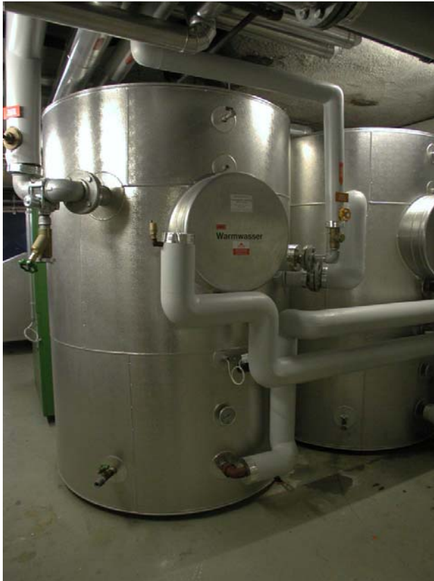
Abb. 3.2 Beide Boiler mit je 2500 Liter Inhalt und eingebauten Wärmetauscher sind im Keller untergebracht. Installateur: Widmer Heizungen Kilchberg. Lieferant: SOLTOP Schuppisser AG, Elgg
