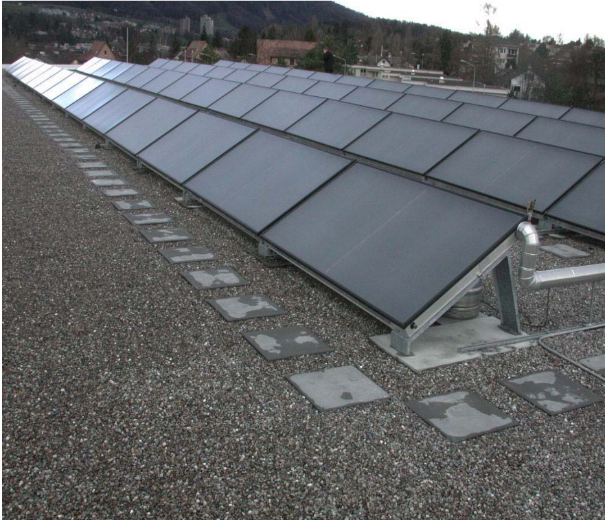
Abb. 3.1 Das 160 m 2 - Kollektorfeld auf dem Flachdach des Hallenbads
