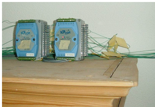
Abb. 5.10: Dezentrale Datalogger (auf Buffetschrank, ausser Kinder-Reichweite)
