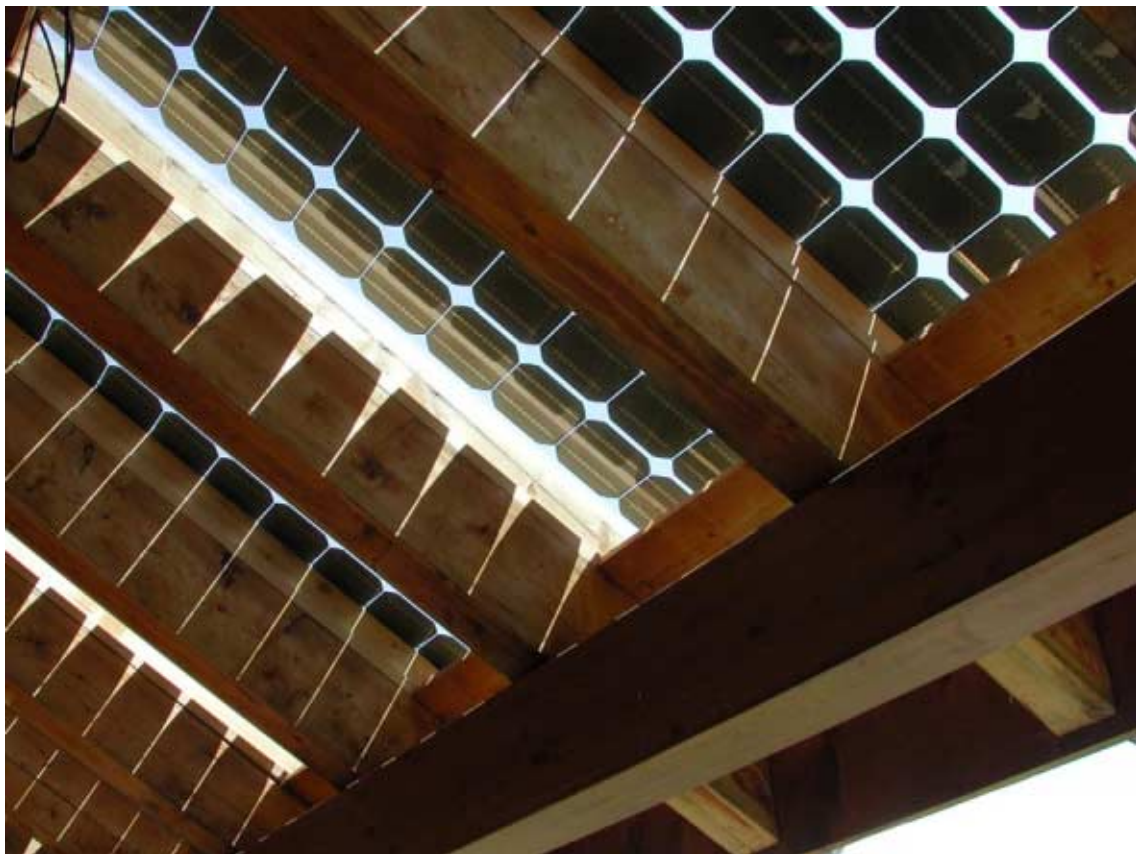
Abbildung 2-5: Photovoltaikanlage. Untersicht des Dachüberhanges über dem Balkon.
