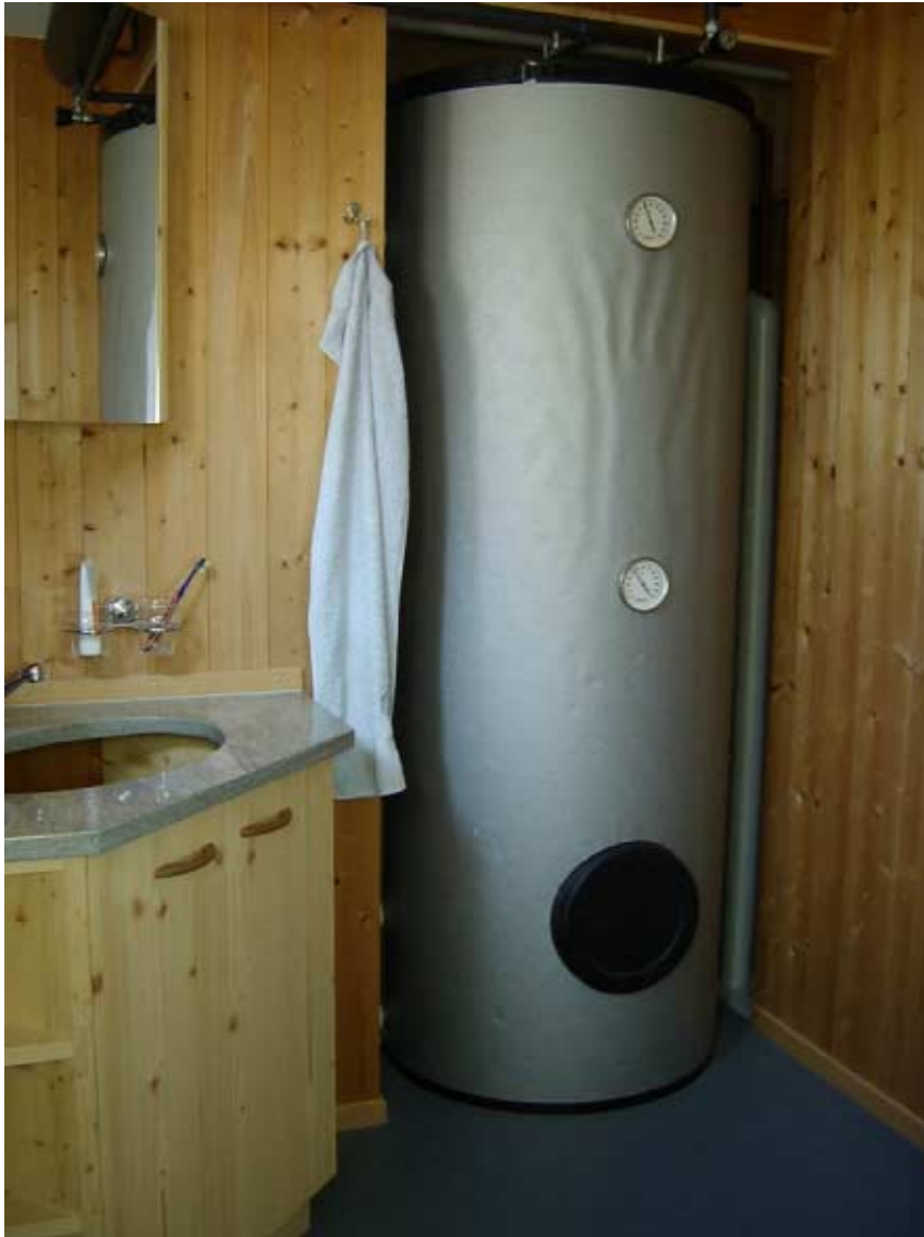
Abbildung 2-16: Solarboiler. Ansicht vom Badezimmer
