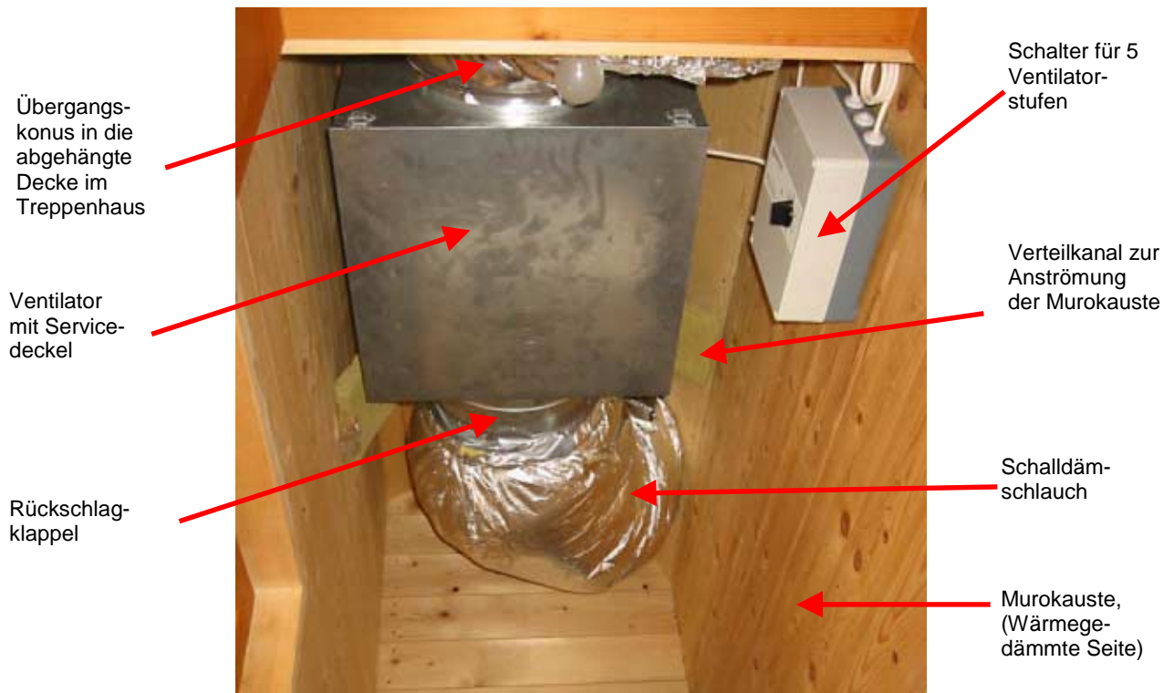
Abbildung 2-12: Technikraum für den Ventilator. Aufnahme von unten gegen die Decke
