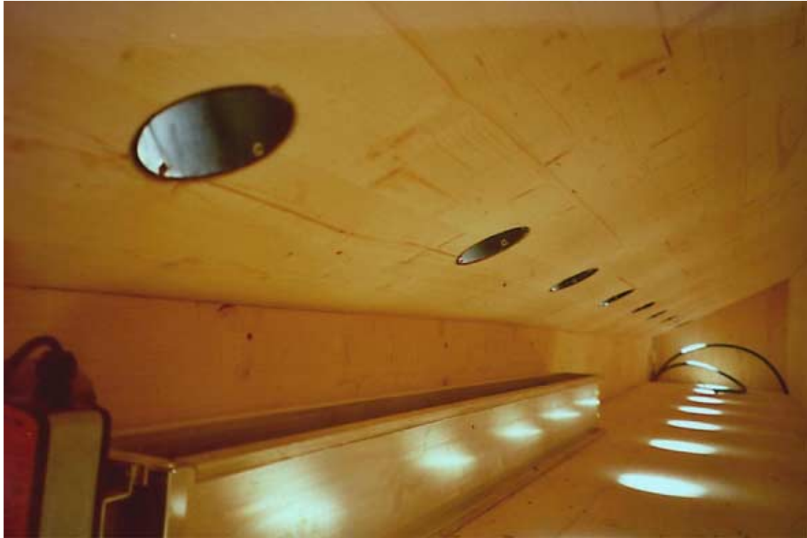
Abbildung 2-4: Westhälfte des Verteilkanals für den Dachkollektor; im Kniestock des Daches integriert. Motorisch angetriebene Rücklaufklappe im Vordergrund.
