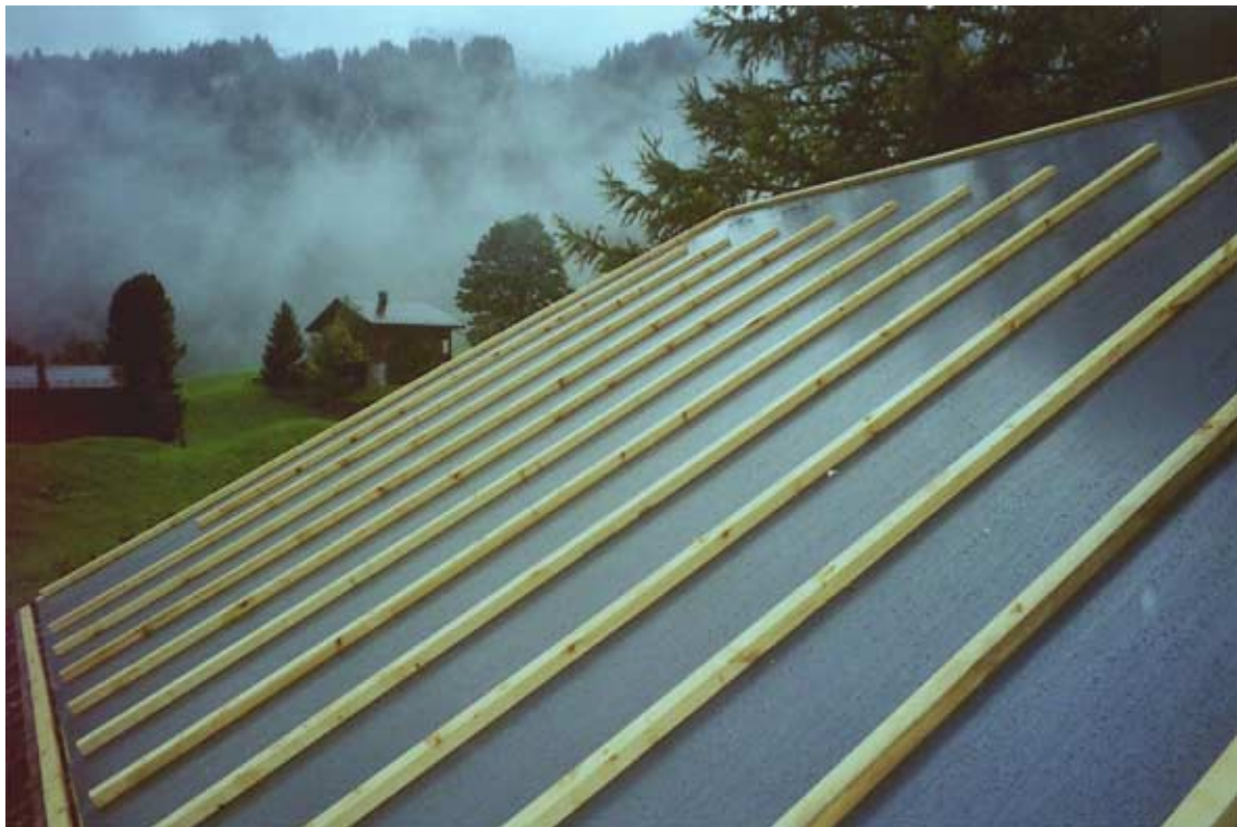
Abbildung 2-2: Dachkollektor vor dem Einglasen. Unterdachbahnen aus Flachblech, Konterlattung, umlaufender Rahmen.
