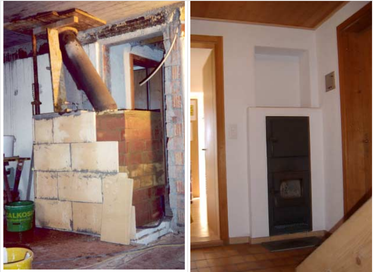
Abbildung 2-18: Die Holzofenzusatzheizung. Einfeuerteil im UG. Links: Ansicht im Rohbau vom Büro aus. Rechts: Fertig vom Treppenhaus aus.
