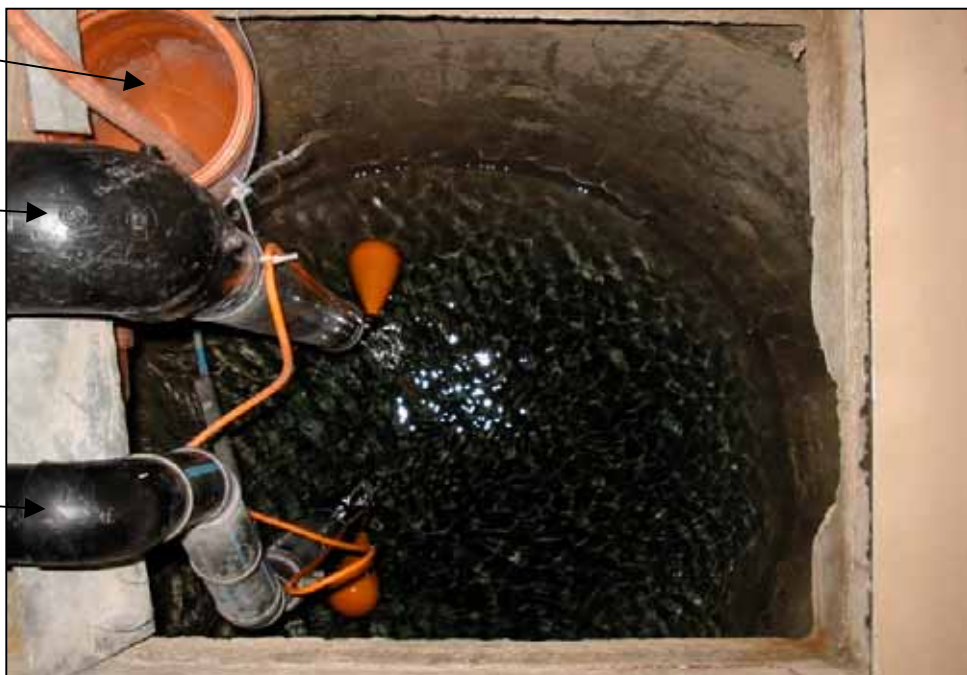
Grundwasserschacht im Feuerwehrgebäude mit Pumpprohren und Regelschwimmern
