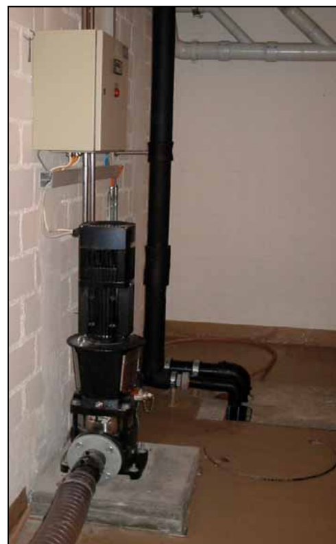
Grundwasserabsenkpumpe im Feuerwehrgebäude mit Steuerkasten und Leitungsrohren
