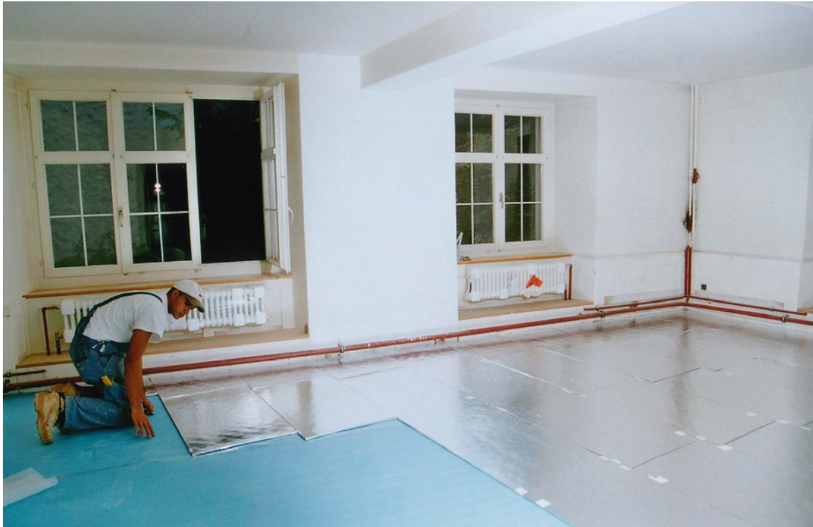
Fig. 2: Einsatz von VIP direkt auf der Baustelle bei Renovationen, für den platzsparenden Einbau in Bodenkonstruktionen (Foto: ZZWancor).
