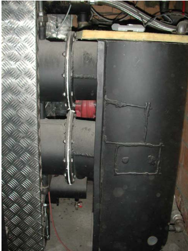
ABB. 3.1.2 Der Zyklon mit einem Durchmesser von 310mm ist wassergekühlt, ebenso die Anschlüsse an den Kessel.
