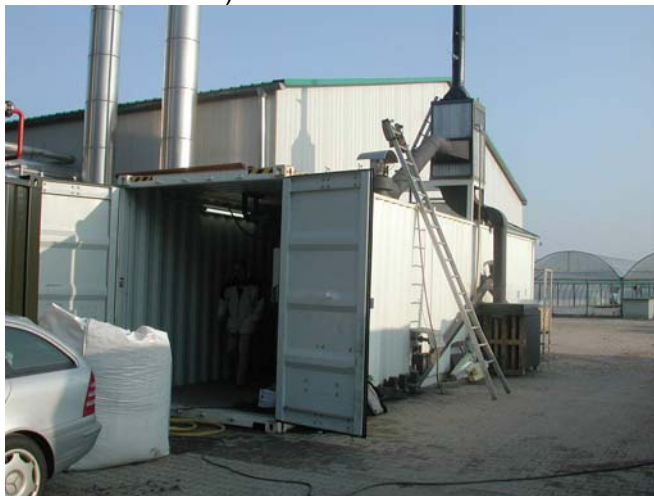
Abb. 3.2.1. Die erste Container-Anlage für die Verbrennung von Biomasse hat eine Leistung von 500 kW.
