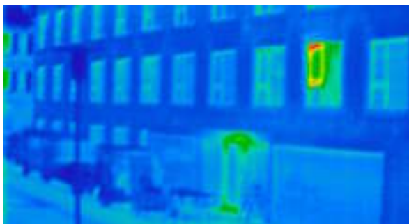
Ein in Kippstellung arretiertes Fenster führt zu einem grossen Lüftungswärmeverlust.
