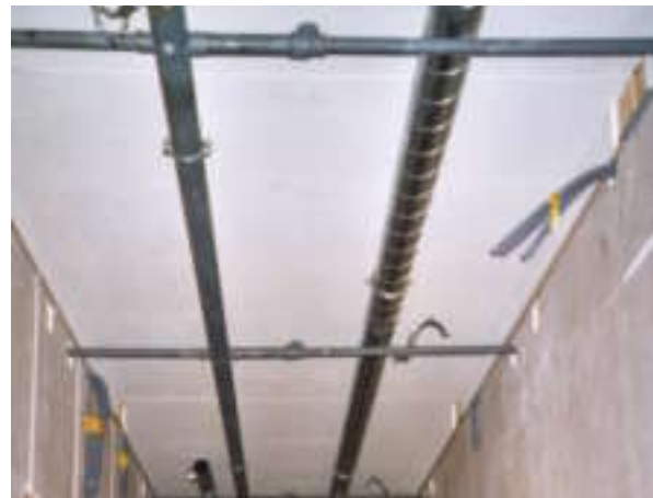
Leitungsführung im Korridorbereich.
