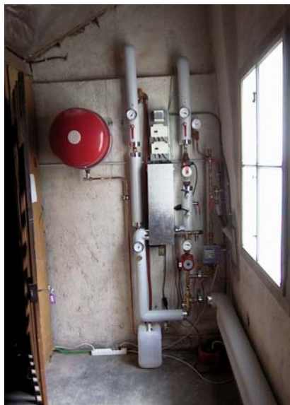
Fig. 3: Solarinstallation im DG von St. Jakobstr. 29, BS
