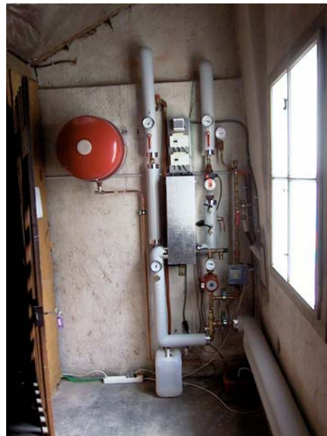
Fig. 2: Solarinstallation im DG von St. Jakobstr. 29, BS
