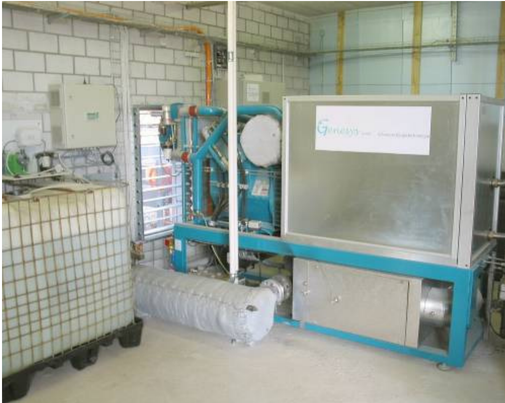
Fig. 9 Technikraum Biogasanlage Graltshausen
