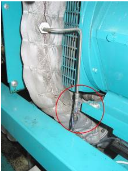
Fig. 3 Ammoniakkeindüßrohr in Abgasleitung nach Turbolader. Im Kreis sichtbar ist das Taktventil zur Dosierung des Ammoniaks.
