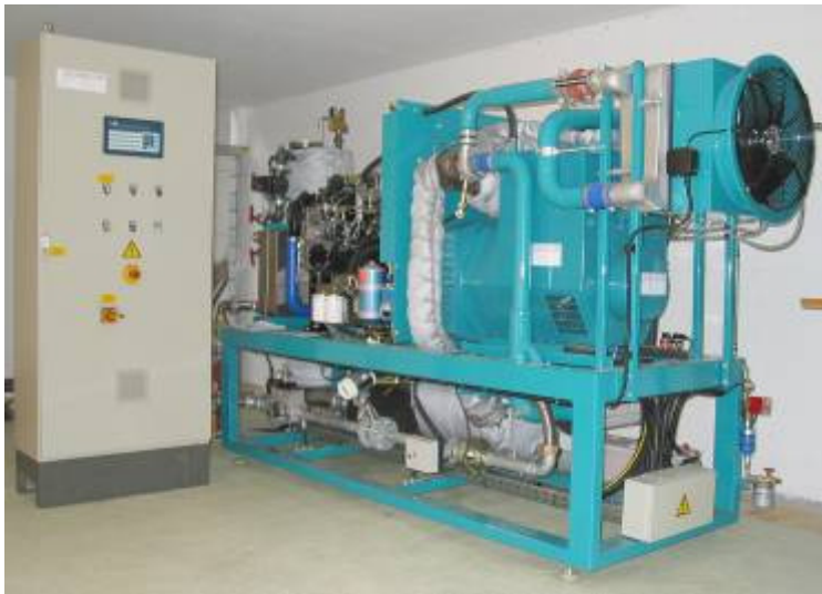
Fig. 2 Erstes 100 kWel BHKW in der Schweiz, eingebaut im Februar 2003
