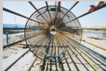
Tubes flexibles pour la circulation de l'eau à l'intérieur d'un pieu
