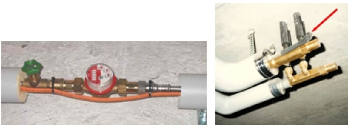
Fig. 1 Heizband-Ausführungsdetails Wasserzähler und Abschluss: wegen fehlender Wärmedämmung laufen diese Teile selbstregelnder Heizbänder mit maximaler Leistung. Trotzdem wird das Warmwasser in diesen Abschnitten abkühlen.
