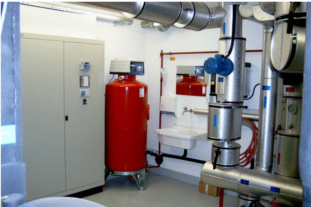
Abbildung/Tabelle 17: Nahwärmegruppe, Expansionsanlage
