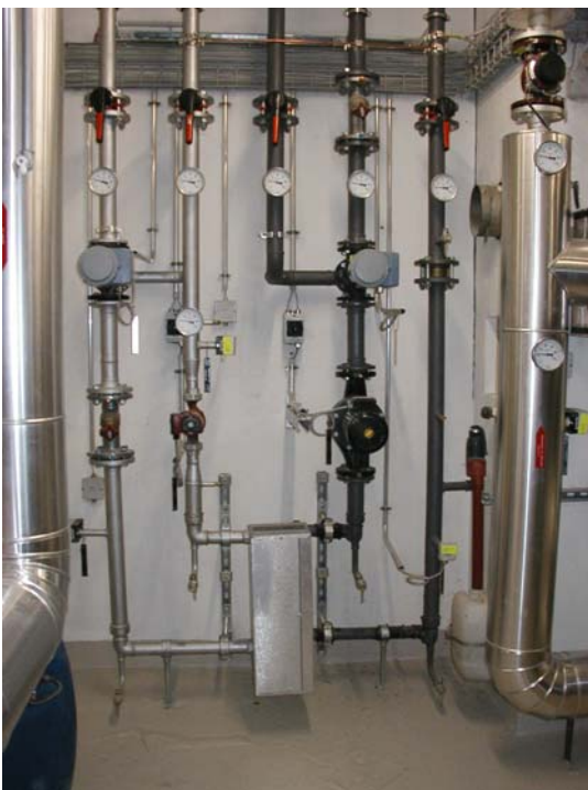
Foto 4: Notkühlung Solaranlage über Rückkühleinheit
