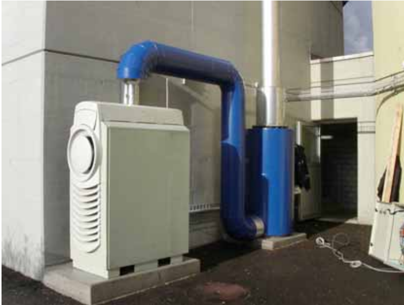
30 kW Mikrogasturbine mit nachgeschaltetem Wärmetauscher auf der ARA Frick
