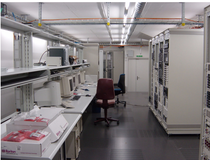
IT-Raum Messe Basel nach der Sanierung
