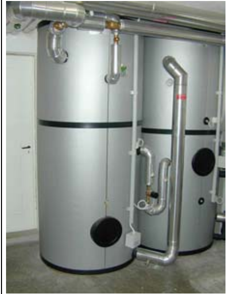
Solarspeicher (rechts); Bereitschaftsspeicher (links)
