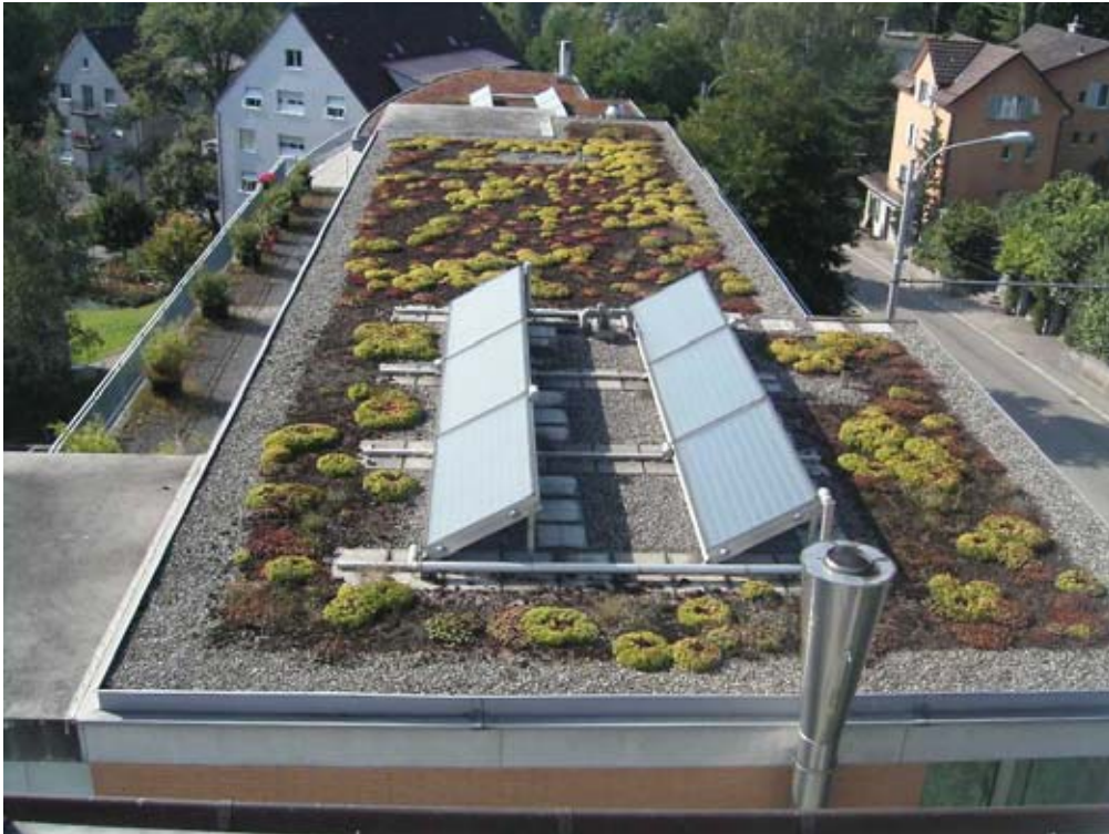
Abbildung 3.5 Solaranlage des Gebäudes Witikonerstrasse 234, Ansicht von Südosten
