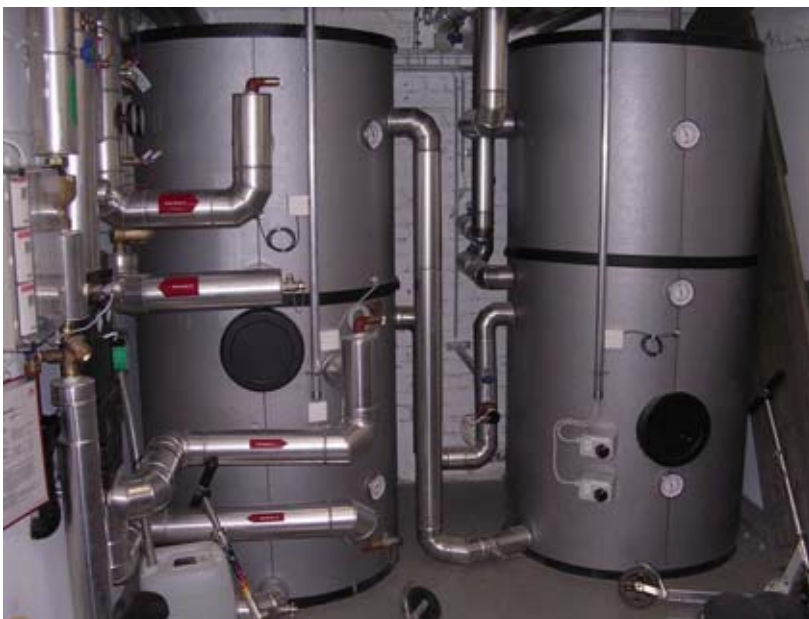
Abbildung 3.4 Solarspeicher (links); Bereitschaftsspeicher (rechts) der Anlage im Gebäude Drusbergstrasse 17
