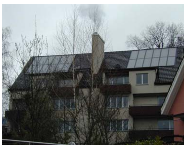
Solaranlage auf dem Dach der Heizzentrale (Drusbergstrasse 22), von Südwesten
