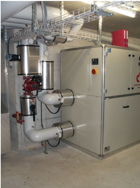
Abb. 12: Wärmepumpe mit Anschlussleitungen auf der Kondensatorseite
