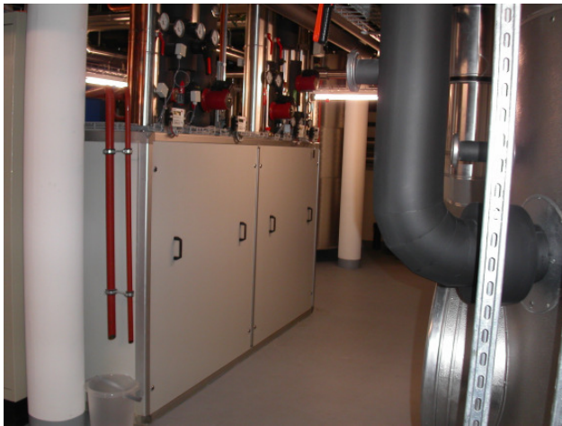
Abb. 5: Wärmepumpen für Heizung und WW-Bereitung im gleichen Gehäuse untergebracht.
