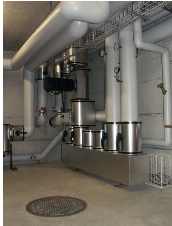
Abb. 13: Verteilung der Heizungs-Fernleitung, die mit Dimensionen von DN80 ab der Zentrale weggehen.
