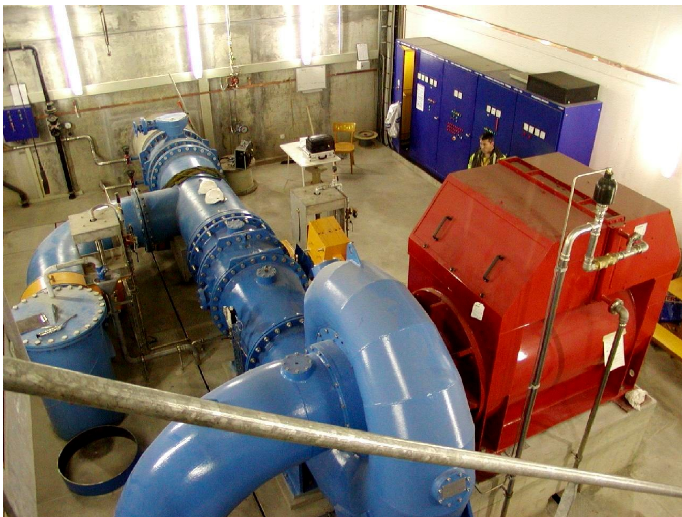
Figure 1 : Vue de la turbine en bleu et du générateur en rouge, depuis l'entrée de la micro-centrale
