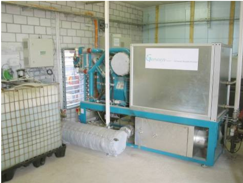
Fig. 3: Technikraum der Anlage Gansner
