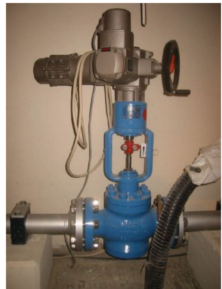
Das automatische Druckreduzierventil baut den Druck von 90 auf 5 bar ab und vernichtet dabei bis zu 150 Kilowatt.
