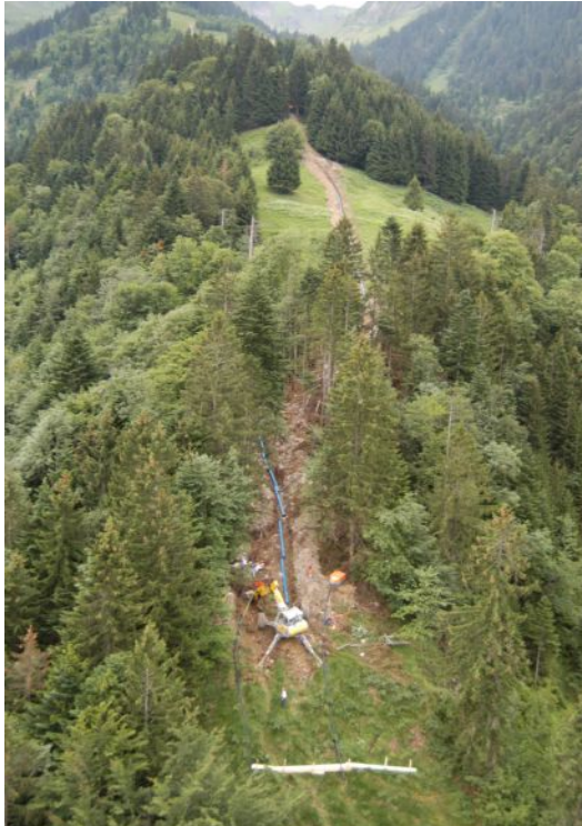
Leitungsbau auf der Moränenkrete mit bis zu 55% Längsgefälle. Die Bagger mussten stellenweise mit Stahlkabeln gesichert werden.
