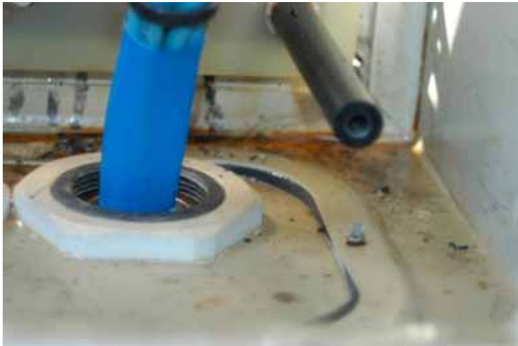
Abbildung 4-41: Feuchtigkeit unten im Schrank
