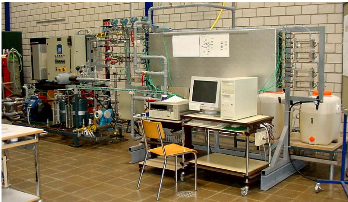
Abb. 4.2: \text{NH}_3 Kälteanlage der HTA Luzern, Gesamtansicht
