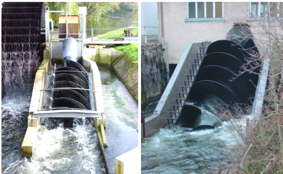
Fig. 4.4 Wasserkraftschnecken: 8.5 kW und 65 kW. d
