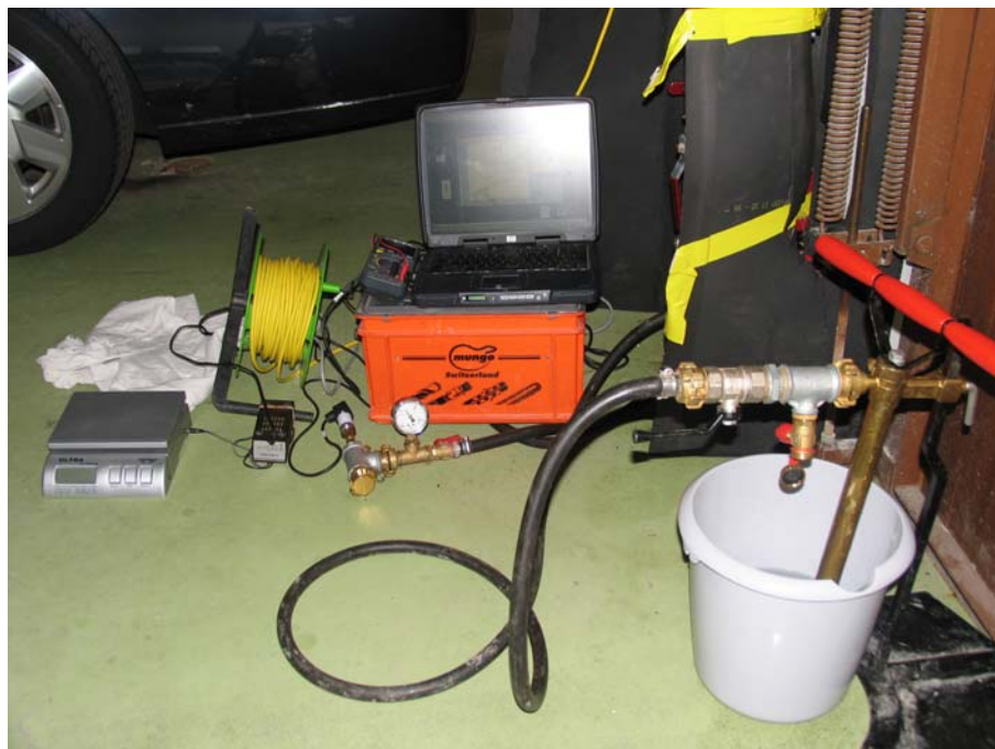
Figur 8: Einfache Prüfeinrichtung mit Hand-Füllpumpe, ergänzt mit elektronischem Drucksensor und Datenerfassungssystem, angeschlossen an EWS Verteiler in Garage.
