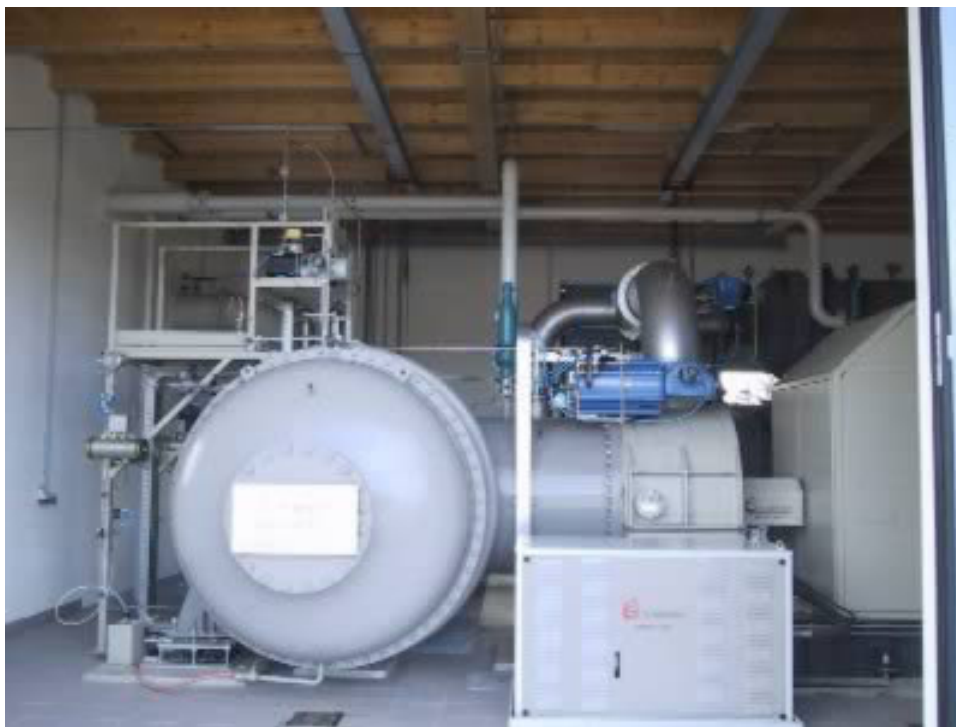
Bild 8: ORC-Turbogenerator der Geothermie-Anlage Altheim (A)
