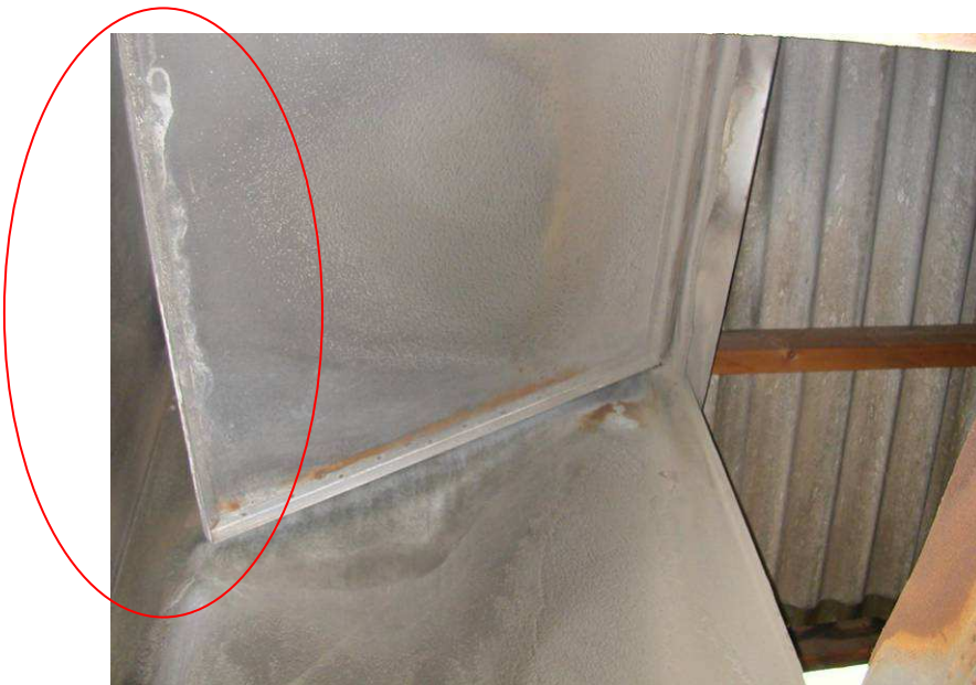
Bild 10 Luft einlass welcher nicht gemessen wurde
