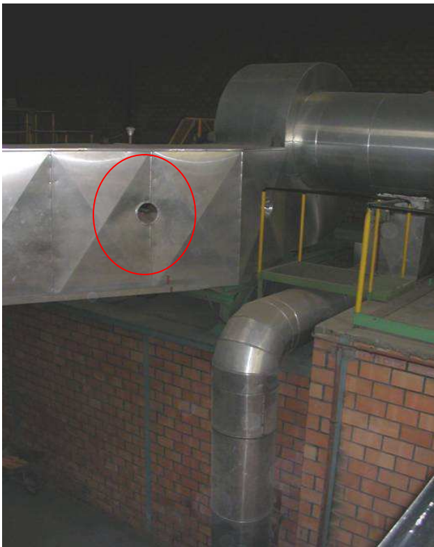
Bild 24 Messposition der Abluft zum Trockner
