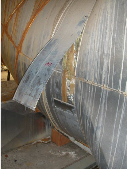
Bild 13 Abluft aus dem Trockner
