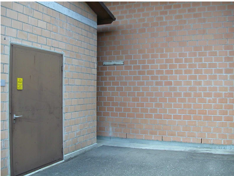
Bild 17 Hintere Trocknungskammerwand, ein Teil der Wand steht hinter einem anderen Gebäude
