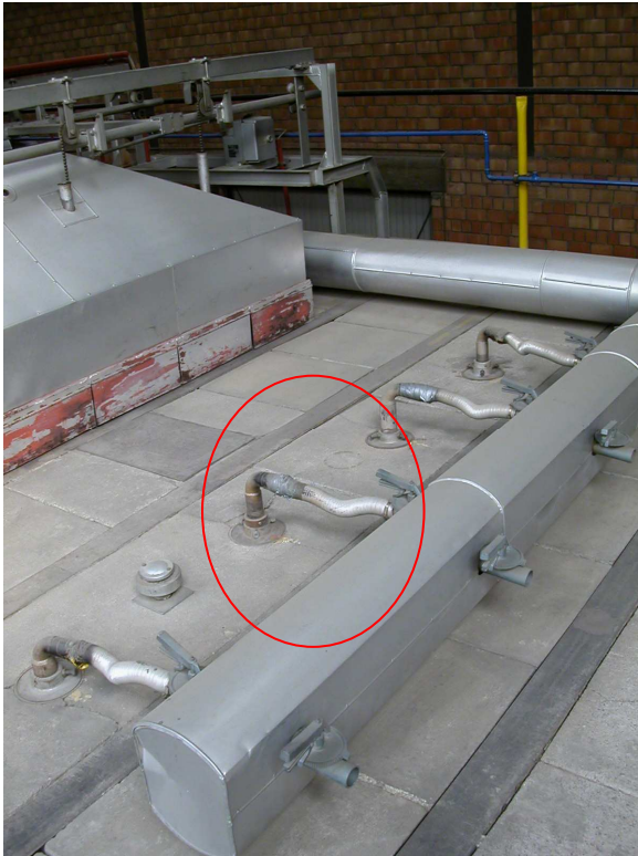
Bild 20 Sturzkühlung auf dem Tunnelofen
