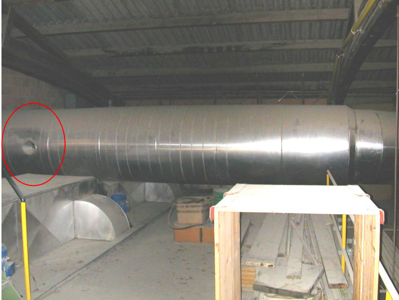
Bild 7 Tunnelofenabluft zum Trockner
