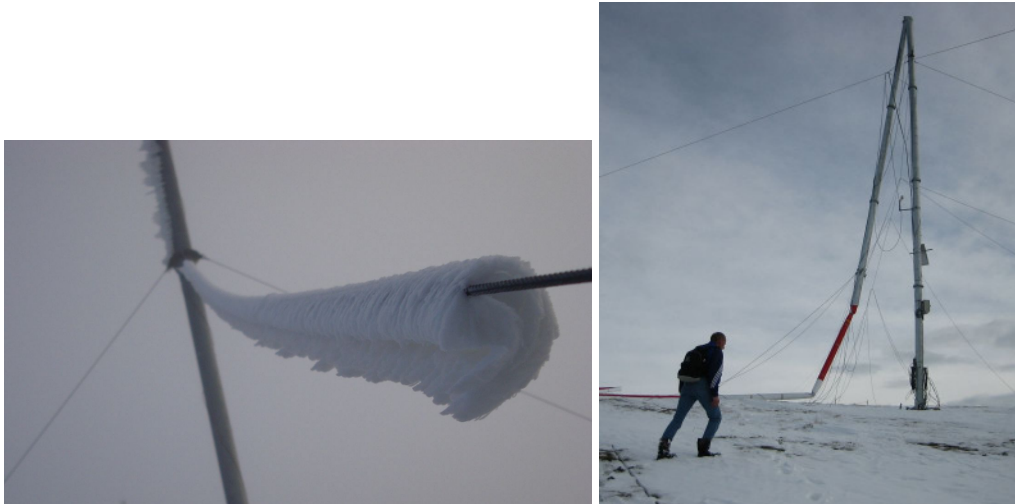
Abb. 7: Links: Zylinderförmiger Eisansatz an Abspannung eines Messmasts (Schwyberg). Rechts: Wegen Vereisung eingestürzter Messmast (Schwyberg).
