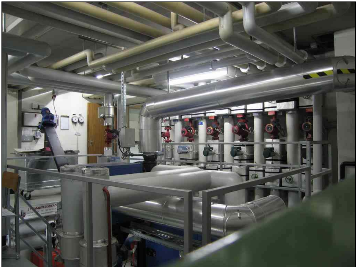
Abbildung 5: Heizzentrale, der Holzkessel (blau) befindet sich in der unteren Ebene der Zentrale
