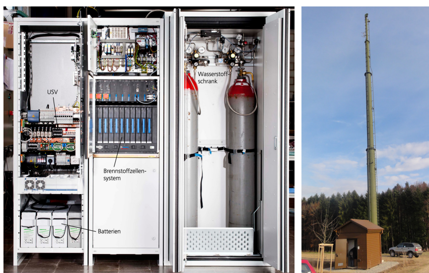
Figur 6: (Links) Integration eines kommerziellen Brennstoffzellensystems (T2000 von ReLion) in ein System zur unterbrechungsfreien Stromversorgung (UPS, Benning) (HTA Luzern). Die Leistung der Anlage liegt bei 2 bis 4 kW mit einer Autonomiezeit von bis zu 48 Stunden. (Rechts) Einsatz des UPS-Systems in einer Antennenanlage des Kantonspolizei Bern für das Sicherheitsfunknetz POLYCOM..
