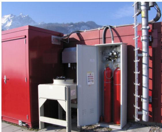
Figur 24: Aussen Ansicht der USV-Anlage für Mobilfunkantennen mit Luftkühler und H 2 -Druckflaschen direkt neben der Antenne [26]
