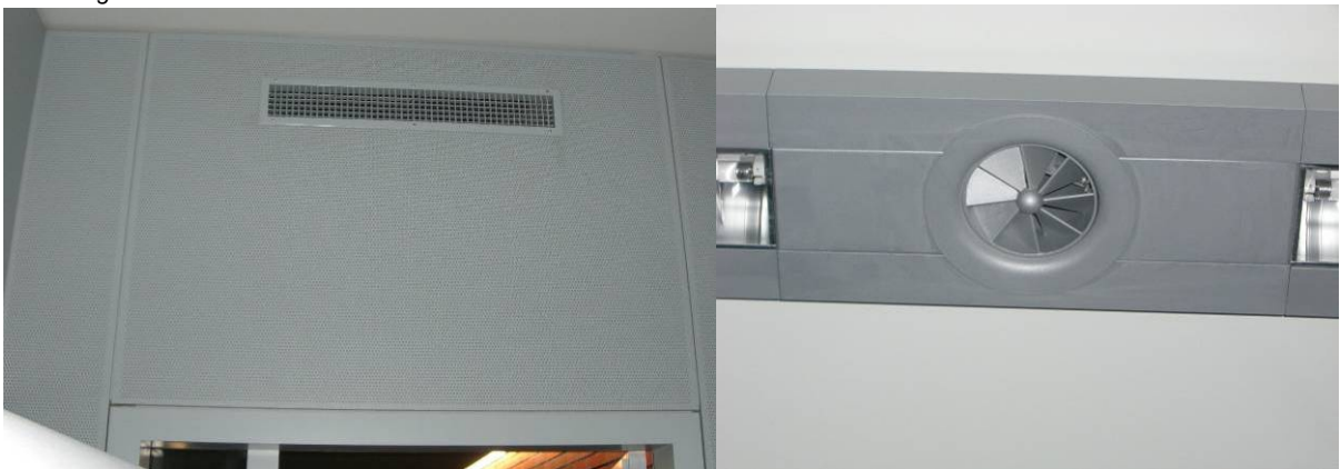
Abbildung 5.4 Mäander: Abluft- (links) und Zuluft-Durchlass in einem Unterrichtszimmer
