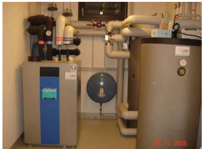
Abbildung 2: Wärmepumpe mit Pufferspeicher (im Vordergrund) und Warmwasserspeicher (im Hintergrund)
