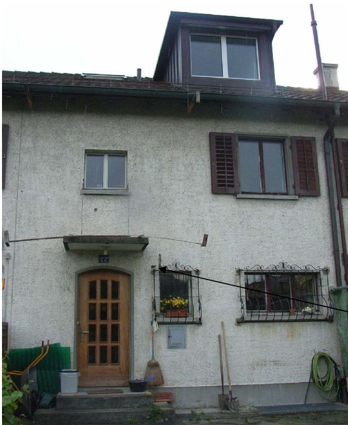
Abbildung 4-14: Fassade vor der Sanierung.
