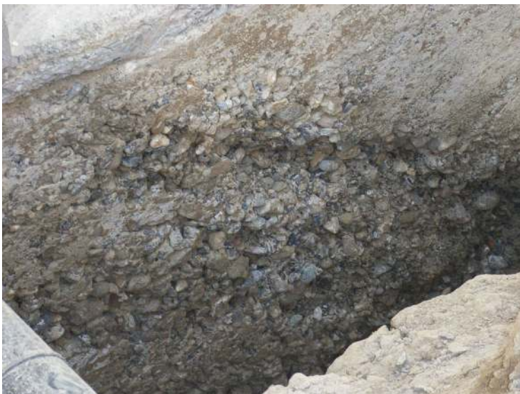
Abbildung 3-15: Schadhafte Beton-UG-Aussenwand unter Terrain.
