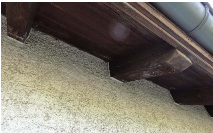
Abbildung 7-2: Ansicht der alten Dachuntersicht.
