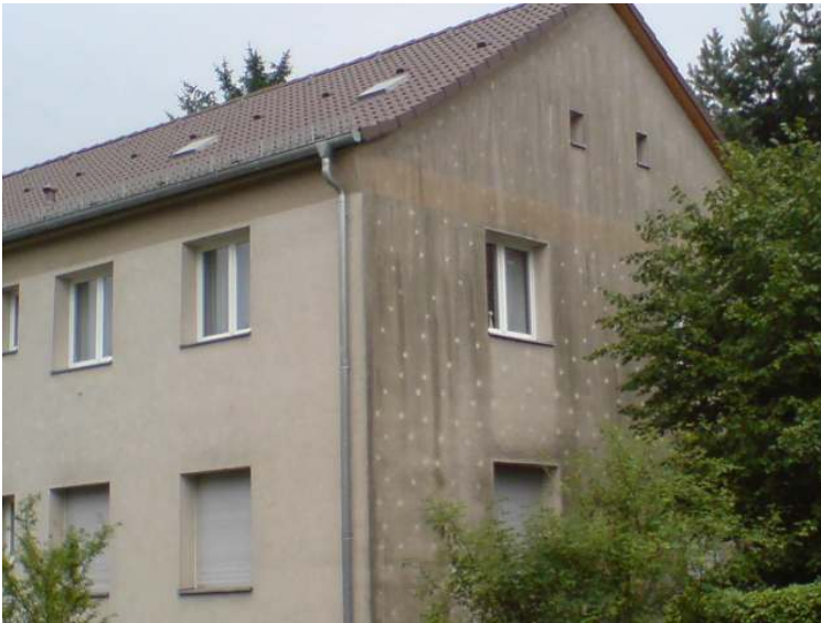
Abbildung 2-4: Algen-/Pilzbewuchs an einer Nordfassade (unbekannt)
