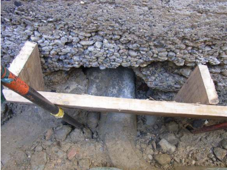
Abbildung 3-16: Offener Rohrdurchbruch in der Aussenwand.
