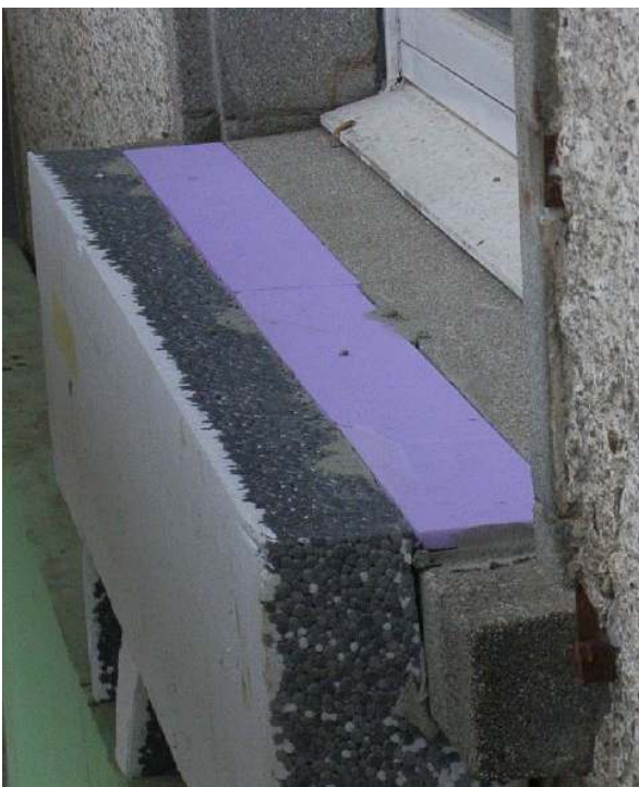
Abbildung 4-10: Wärmebrückenkaschierung bei Sims/Türschwelle
