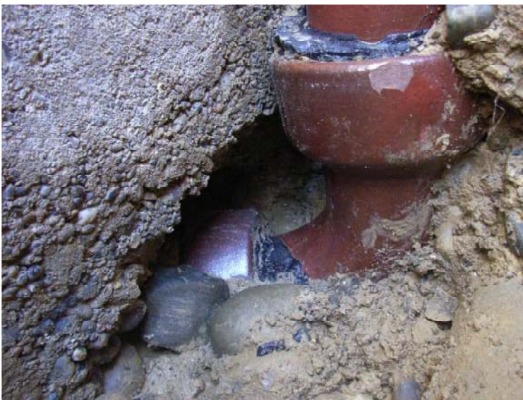
Abbildung 3-18: "Vergessener" Mauerdurchbruch für die Dachwassereinleitung
