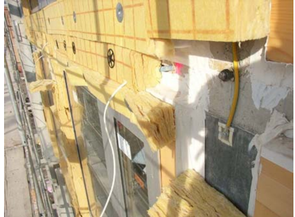
Abb. 2: Dieses schlechte "Beispiel" zeigt, wie wichtig die Qualitätssicherung durch die Bauleitung gewesen wäre..... (Foto: Amena)
